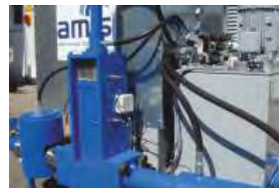
Staubdichter Füllschacht mit Sensoren
